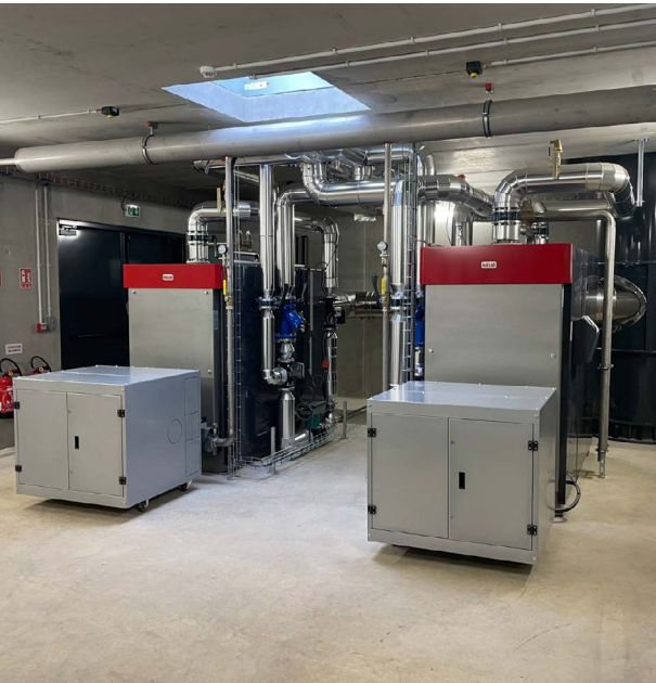
Réseau de chaleur de Varzy.
