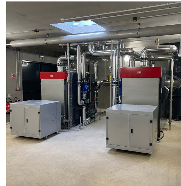
Réseau de chaleur de Varzy.
